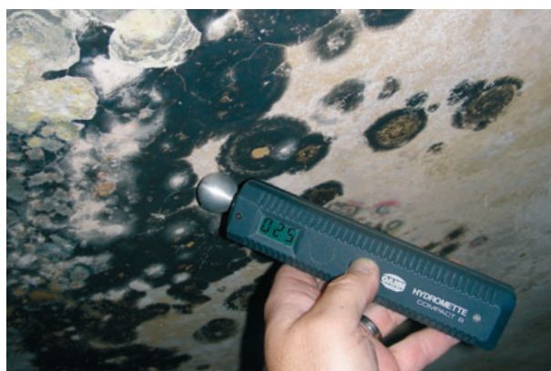
Bild 1 und 2: Typische Schimmelschäden
