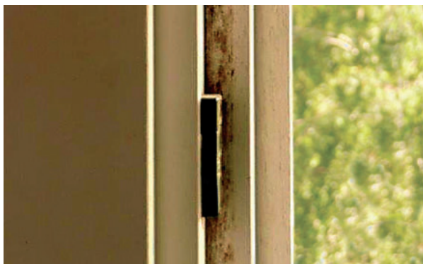
Bild 6: Schimmel am Fensterrahmen
